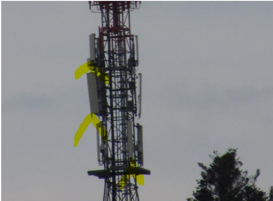
Senderturm Gloten Mobilfunk-Abschnitt, von der Wilerstrasse aus.
