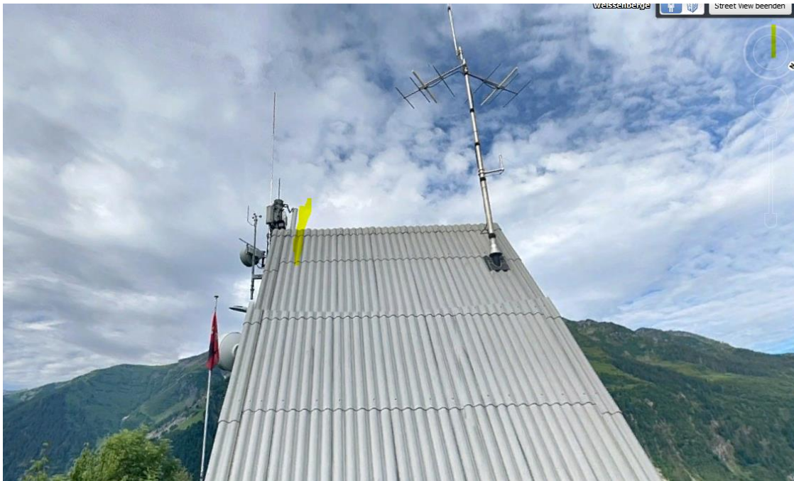
Der Sender mit down tilt ins Tal - strahlt hier optimal direkt über die Strasse ein
