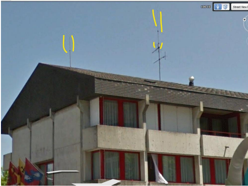
2 Sender auf dem Dach
